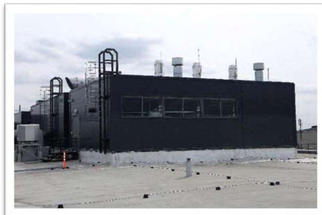
Фото 1. Крышная котельная торгово-развлекательного комплекса Галерея, Санкт-Петербург, Лиговский пр., д.д. 26-38, литера А
