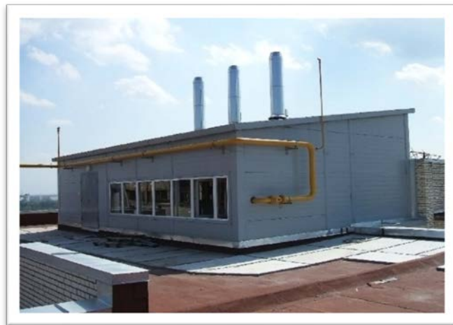
Фото 2. Крышная котельная жилого дома, Санкт-Петербург, Северный пр. д. 26, корп. 2.
